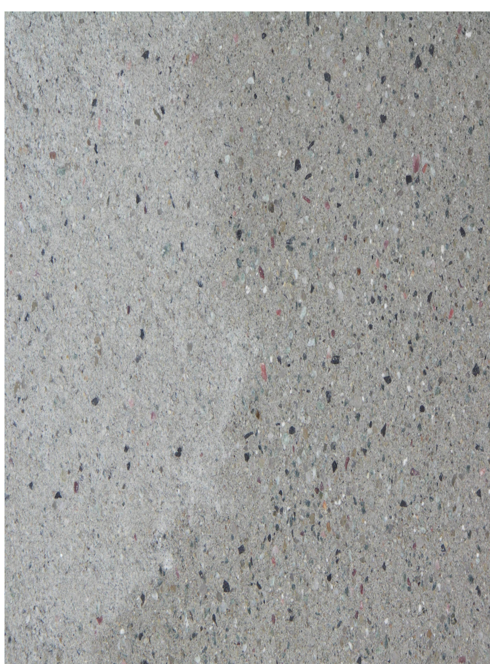
oben: Im linken Bereich haben sich an der Oberfläche Bindemittel angereichert, was zu einer Sinterschicht und damit zu einer Störung des Wasseraustausches führt. Im rechten Bereich ist durch Abtupfen und Ausmagen der Oberfläche eine ideale Mörteloberfläche entstanden. Verschiedene Zuschläge geben dem Mörtel eine sandsteinähnliche Oberfläche.
