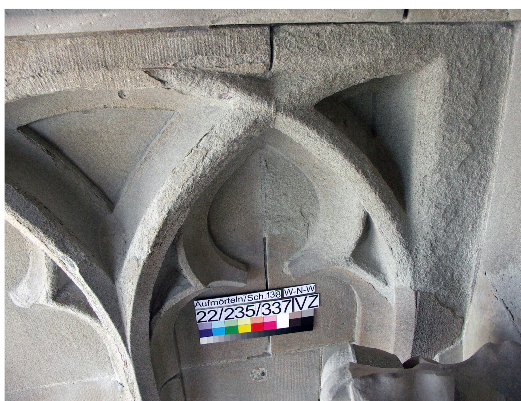
Dieses Blendmasswerk (Treppenturm Turmachteck) zeigt eine grossflächige Schädigung durch Absanden und dünne Schalenbildung. Der Materialverlust beträgt jedoch nur 5 - 10 mm, sodass kein Kernmörtel aufgetragen werden musste.
