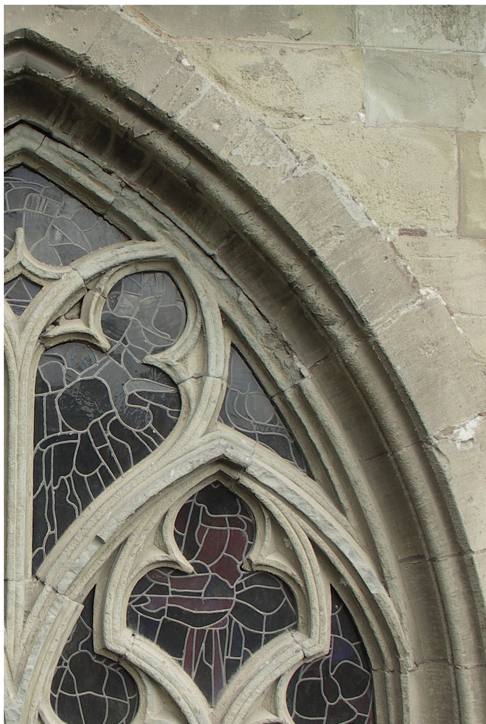
Vorzustand des rechten Masswerkbereichs der Schützkappelle. Deutlich zu sehen sind die vielen Fehlstellen und defekten Fugen (Foto: Urs Zumbrunn)
