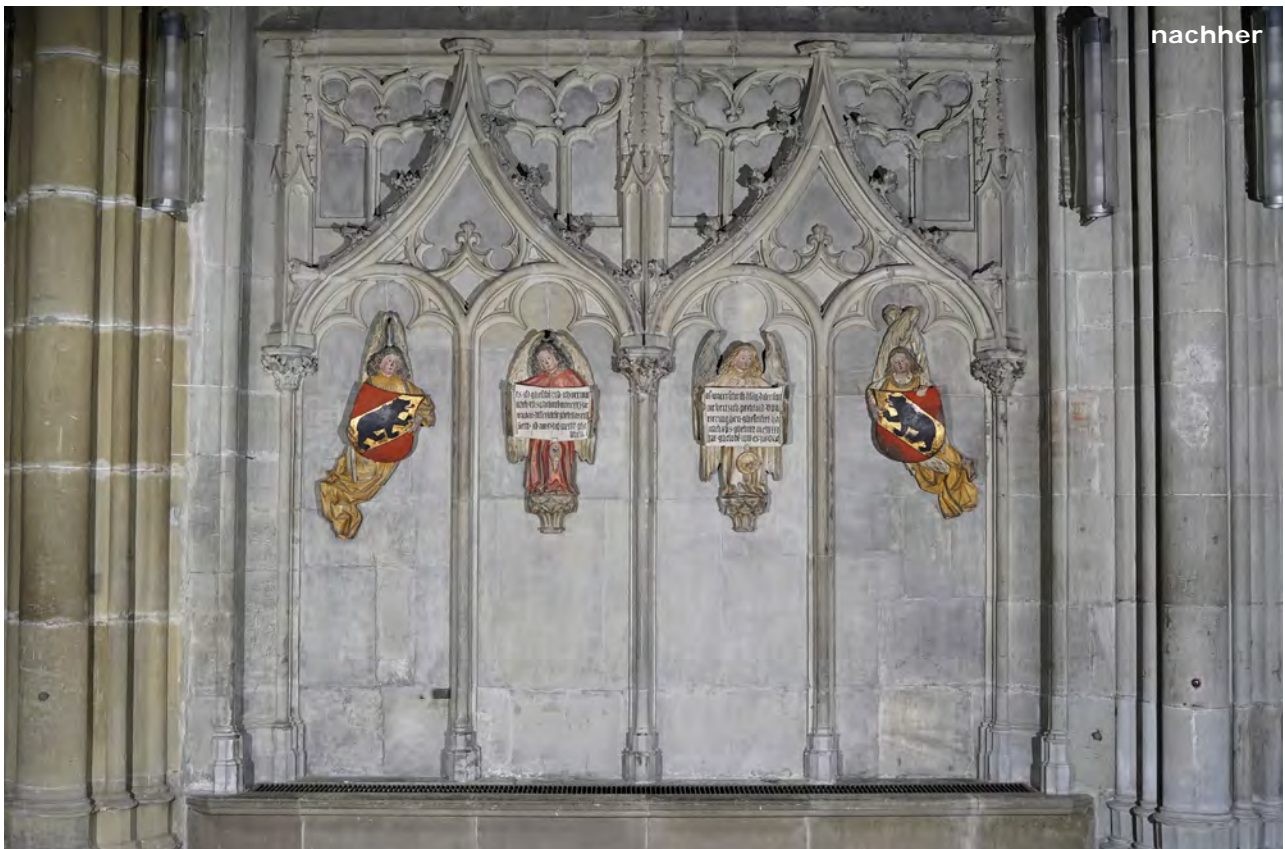
Nordwand im Altarraum: oben Vorzustand, unten Schlusszustand. Die Figuren wurden schonungsvoll abgesaugt, trocken und anschliessend nass mit Wattestäbchen gereinigt. Mit diesen Massnahmen konnte die Wahrnehmbarkeit und Wirkung der teils ursprünglichen, teils später überfassten Oberflächen und Polychromien deutlich verbessert werden. Der sehr fleckige Wandhintergrund wurde mit reversiblen Retuschen beruhigt. Fotos: (o.) Nick Brändli, Zürich, (u.) Cornelia Marinowitz, Tengen (D).
