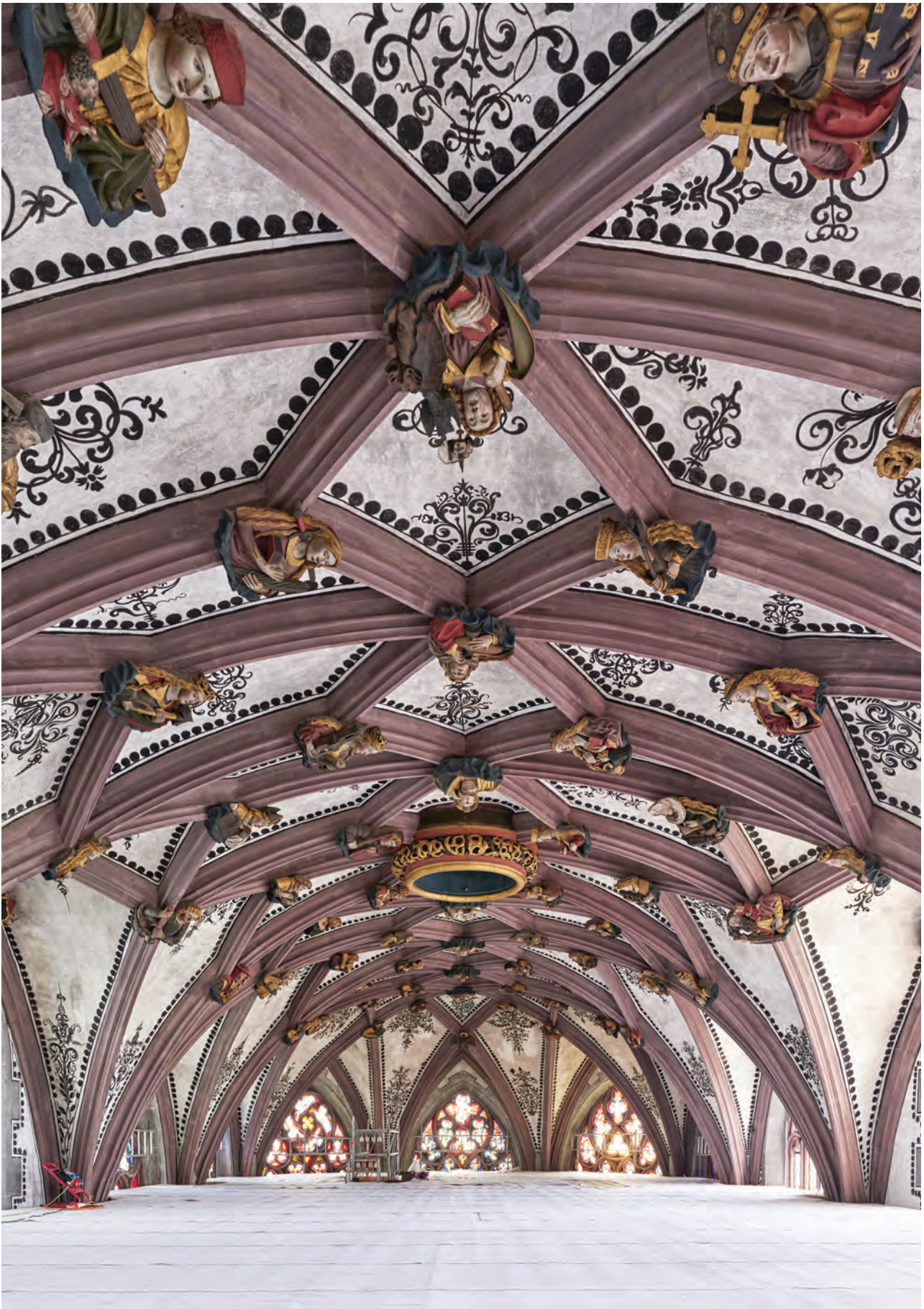
Ein letzter Blick von der obersten Gerüstplattform in das fertig restaurierte Chorgewölbe. Der Abschied von den 86 Figurenbüsten, welche von nun an wieder nur noch aus grosser Distanz zu sehen sind, fiel allen Beteiligten schwer. Foto Nick Brändli, 2017.
