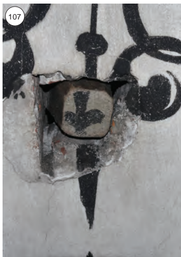
107 Das Holz, im nachträglich durch den Putz gestossenen Abzugsloch, wurde durch die Bemalung in das Ornament integriert, um die Fehlstelle schon 1517 nicht so auffällig wirken zu lassen.
