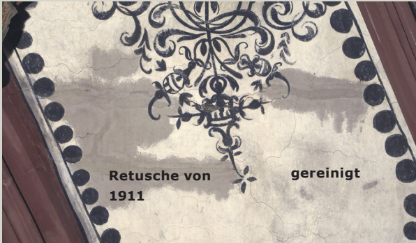
Nach der Reinigung: grau vermörtelte Risse gut sichtbar
