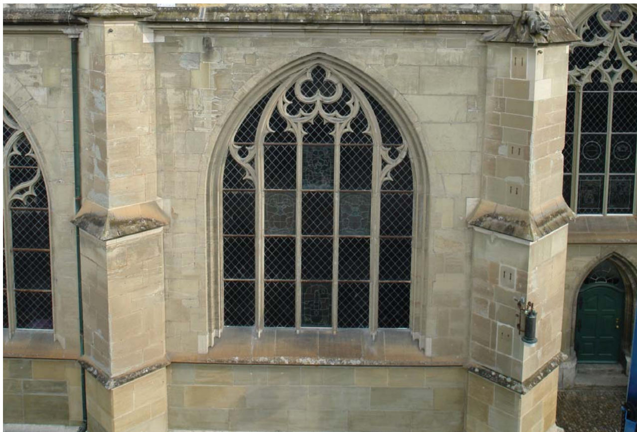
(u.) Bereich Brügglerkapelle, Südfassade. Vorzustandsfoto Herbst 2011.
