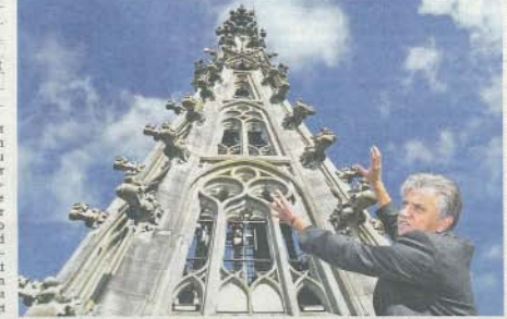
Münsterarchitekt Hermann Häberli zeigt in 72 Metern Höhe, wo das nächste Gerüst hinkommt. FOTO: MICO
