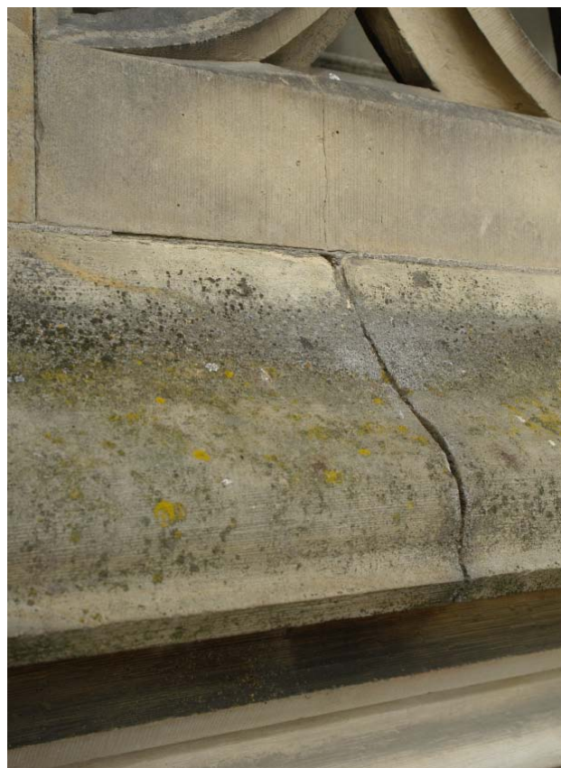
(v.o.n.u.) Typische Schadensbilder am Viereck Ost: Organischer Bewuchs und beginnende Schalenbildung / Schäden in Ausdunstungszonen / Offene Fugen.
