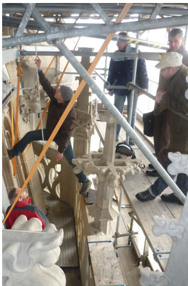
(u.l. und u.r.) Besprechung der Verstärkung des bestehenden Gerüstdaches mit den Bauingenieuren.
