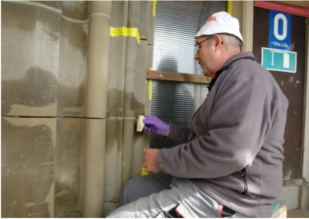
(o.) Aufmörtelungen und Ausfugen an einem Gewände- profil am unteren Achteck Süd.
