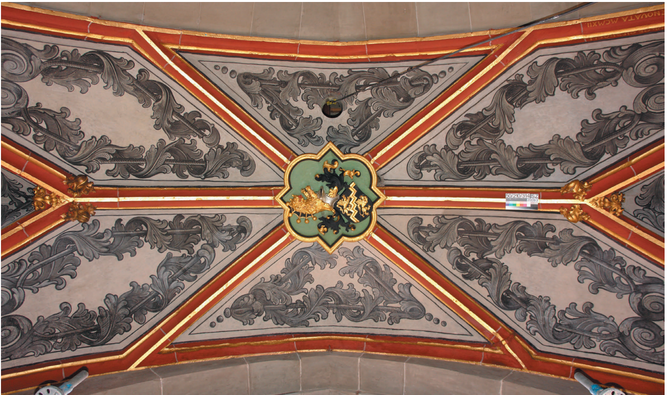
Gewölbe der Diesbachkapelle (Seitenkapelle Feld 50 Süd). Oben: Vorzustand vom Oktober 2007, unten: Zustand nach erfolgreicher Restaurierung im März 2009 (beide Fotos: Urs Zumbrunn, Restaurator HFG).
