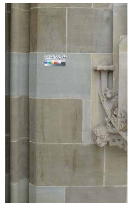
Gleicher Bereich wie oben nach den Finisharbeiten wie Ausfugen und Retuschen mit Silikatcreiden
