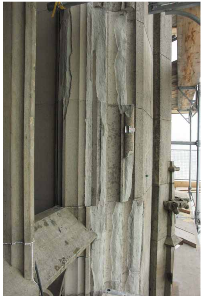
Schäden im Fenstergewände, oberes Achteck Nordwest
