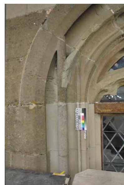
Detail des Fenstergewändes aus der Bauzeit um 1520 mit einzelnen Ersatzsteinen aus Zuger Sandstein aus dem 19. Jh.
