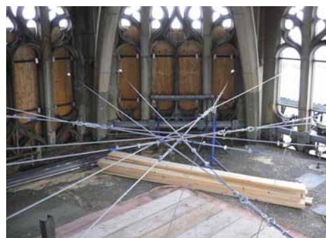
Spannseile zwischen den Helmrippen als Sicherung vor dem Abbruch der darunterliegenden Stahlbetonkappen
