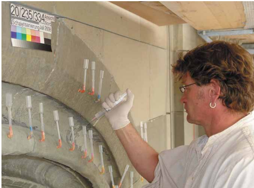
Restaurierung der Risse und Schalen am Fenstermasswerk an der Nordseite
