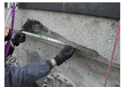
Abnehmen von gerissenen Teilen
