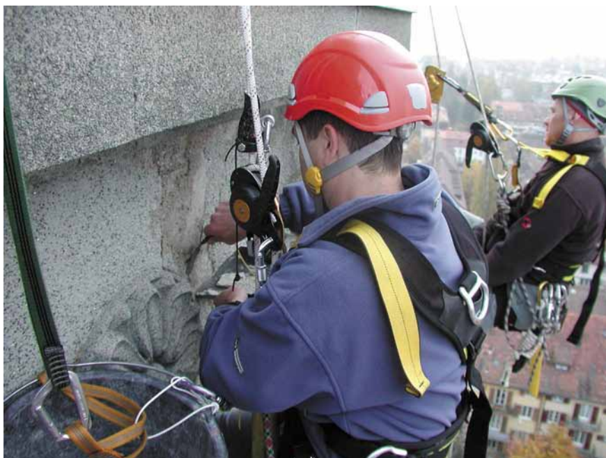
Abnehmen loser Putzteile
