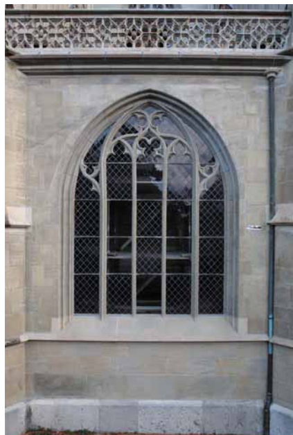
links: Aussenansicht der Diesbach-Kapelle an der Südfassade, Vorzustand vom Oktober 2007 (Foto: Urs Zumbrunn, Restaurator)
