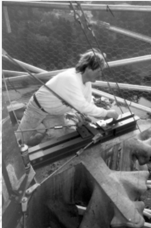
Links: Alte Sicherungsmanschette. Im Vordergrund zweite provisorische Sicherung mit Stahlseilen
