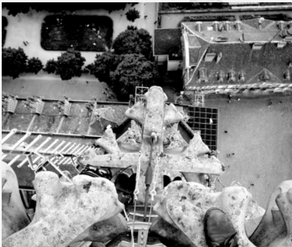
Aufsicht Kreuzblume mit alter Sicherungs- konstruktion
