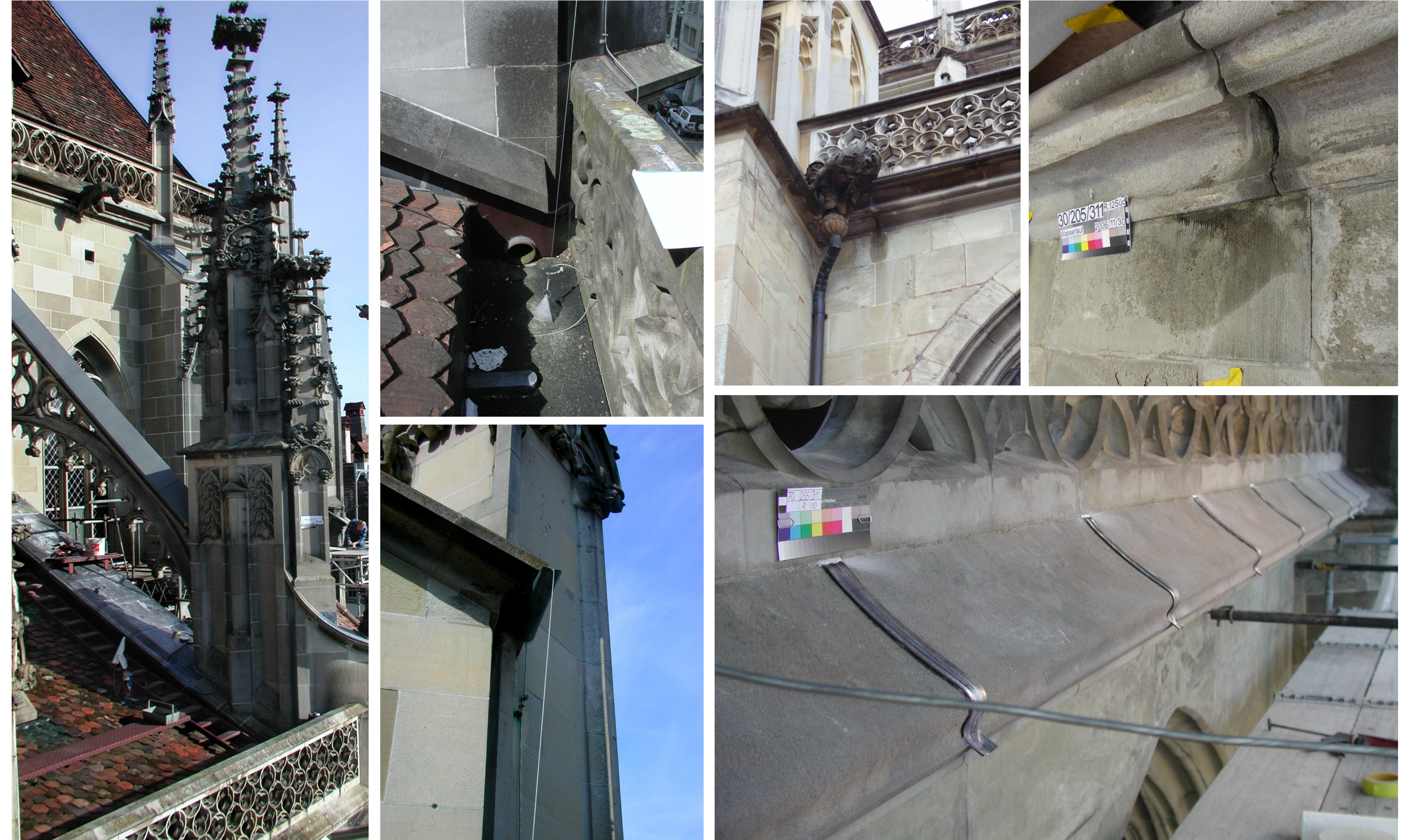
Kleine Ursache grosse Wirkung: Da das Regenwasser am Strebepfeiler 25 der Nordseite schon seit längerem unkontrolliert von der Abdachung auf die Brüstung tropfte, zeigte sich dort mittlerweile eine starke Krustenbildung mit Moos und Algenbefall. Ausserdem wurde bei einem Kontrollgang zusätzlich am daneben liegenden Pfeilerschaft eine beschleunigte Verwitterung (Sanden und Abplatzungen) festgestellt. Daher wurde von einer Hebebühne aus eine kleine Wasserrinne sowie ein feines Drahtseil angebracht, welches das Wasser neu gezielt in den Galerieboden ableitet.
