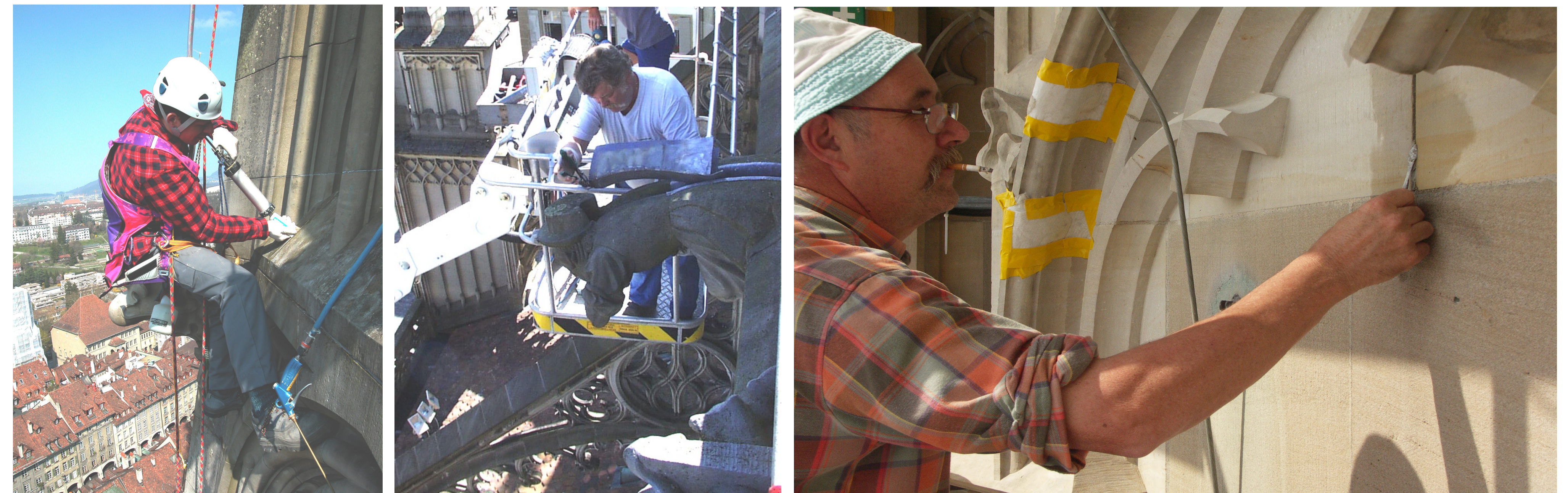
Notdürftiges Schliessen von offenen Fugen am Turmhelm
