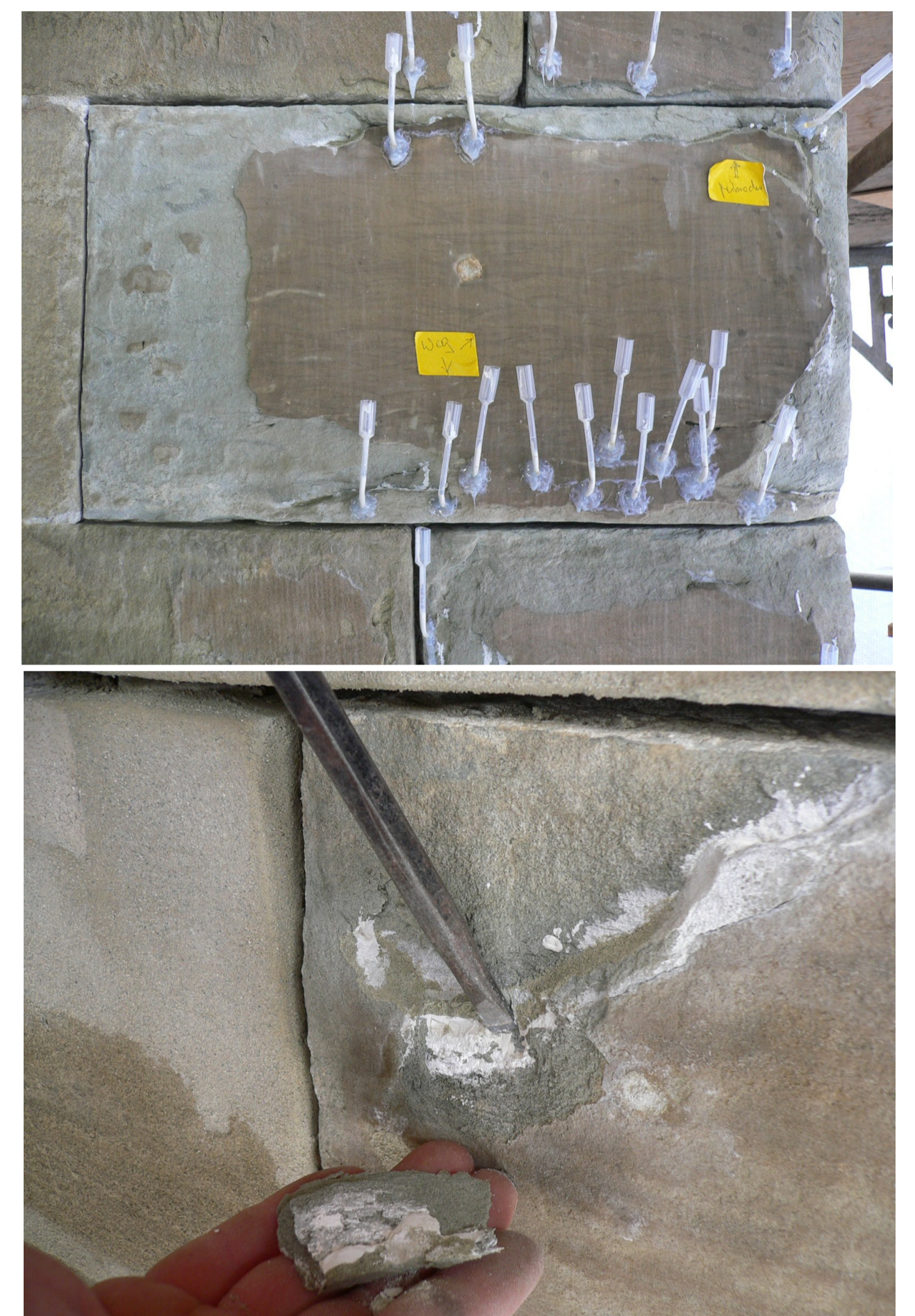
Versuchsreihe am Bau: Die Schale wurde später zur Überprüfung abgenommen: Es zeigte sich, dass das Verfahren den gewünschten Erfolg versprach.
