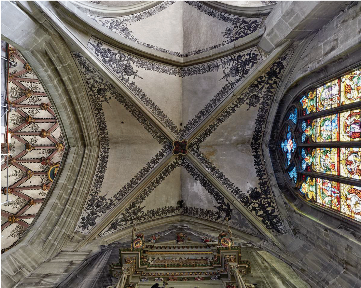
Vorzustand Gewölbe Matterkapelle | Foto Nick Brändli, 2018
