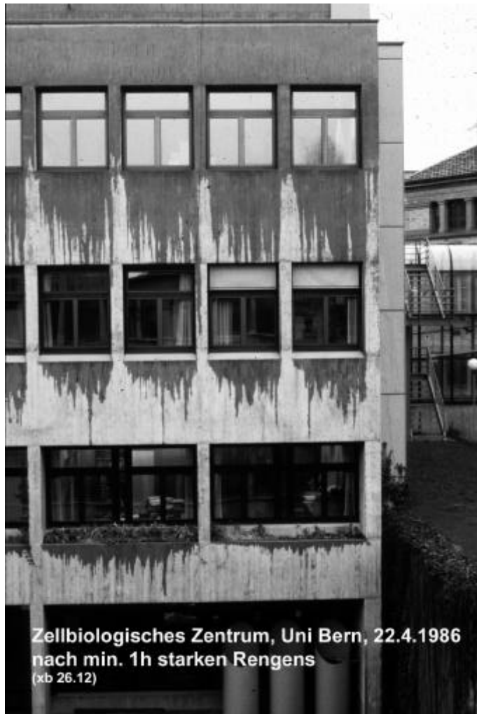
Figur 1: Regennasse Süd-Fassade aus Sichtbeton. Im obersten Stock ist die Fassade deutlich nasser als im darunter liegenden Stockwerk.
