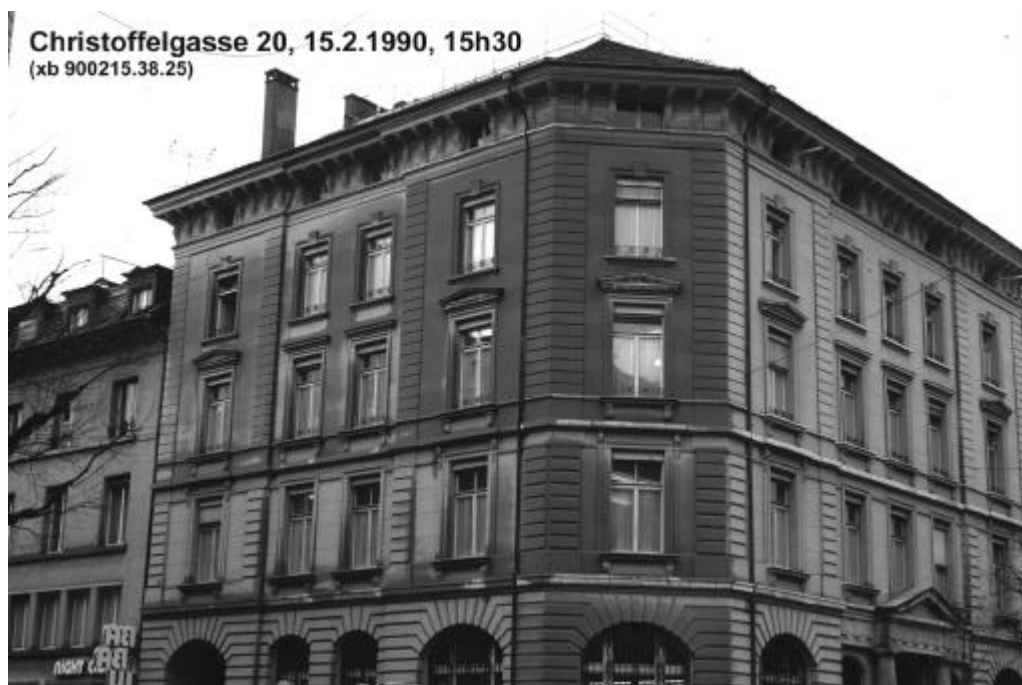
Figur 2: Regennasse West-, Südwest- sowie Südfassaden. Auch hier ist zu erkennen, dass die Fassaden in den tiefer gelegenen Stockwerken weniger nass sind als in den oberen. Zudem bewirken bereits gering vorspringende Stellen, dass die darunter befindlichen Fassadenteile im Regenschatten sind.
