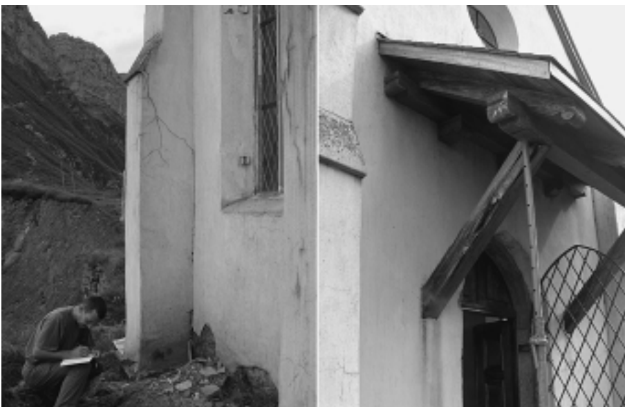
Risse im Stützfeiler und mangelhaft konstruiertes Dach.
