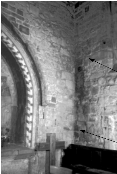
Chapelle sud paroi est : la maçonnerie portant la peinture est saine, l'enveloppe extérieure contiguë ne l'est pas.
