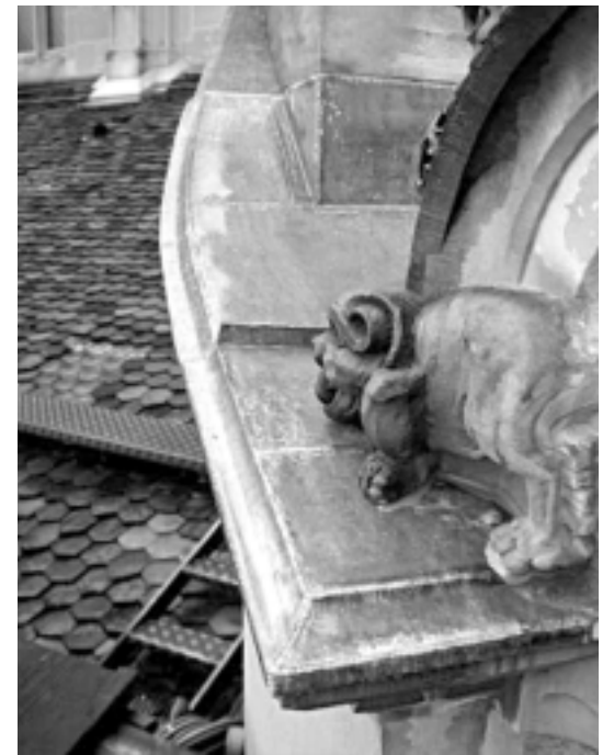
Abdeckblech aus Blei auf einem Kaffgesims.
